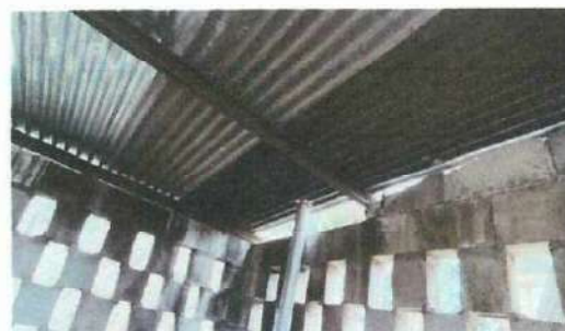
Foto 2: LAS LAMINAS SE ENCUENTRAN EN MAL ESTADO Y POR LO MISMO NECESITAN SER SUSTITUIDAS
