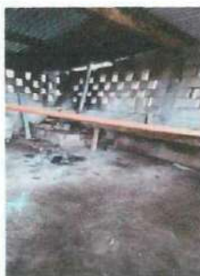
Foto 3: PISO DE COCINA EN MAL ESTADO, NECESITA SUSTITUCION
