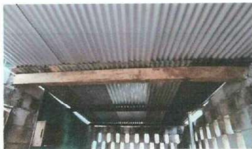
Foto 1: SE NECESITA SUSTITUIR LA ESTRUCTURA METALICA YA QUE SE ENCUENTRA MUY DETERIORADA.
