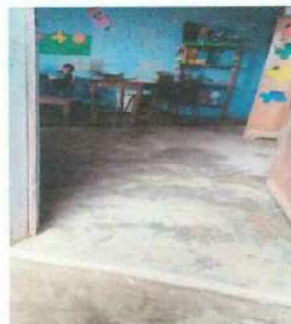
Foto 4: Sustitución de piso rústico que se encuentra en mal estado
